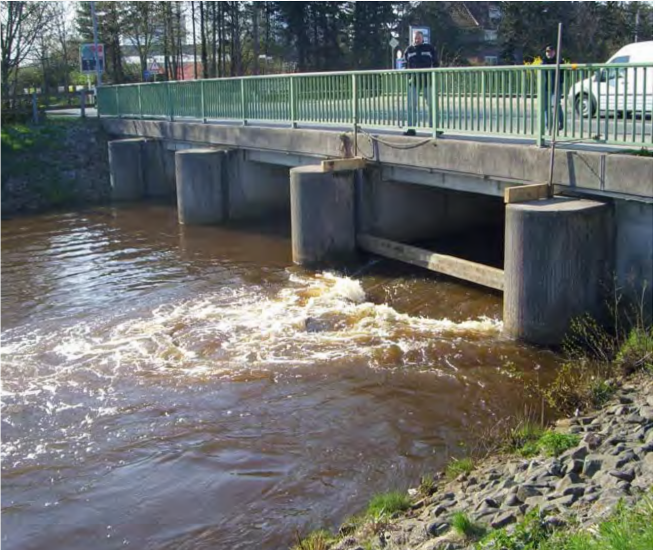
Der angestrebte Zustand (hier beim Probelauf): Wasser strömt aus der Hunte in den Hemmelsbäker Kanal. Durch das geplante Entfernen der Rückstaubohle kann ein bis zu 50 cm höherer Wasserstand einlaufen.
