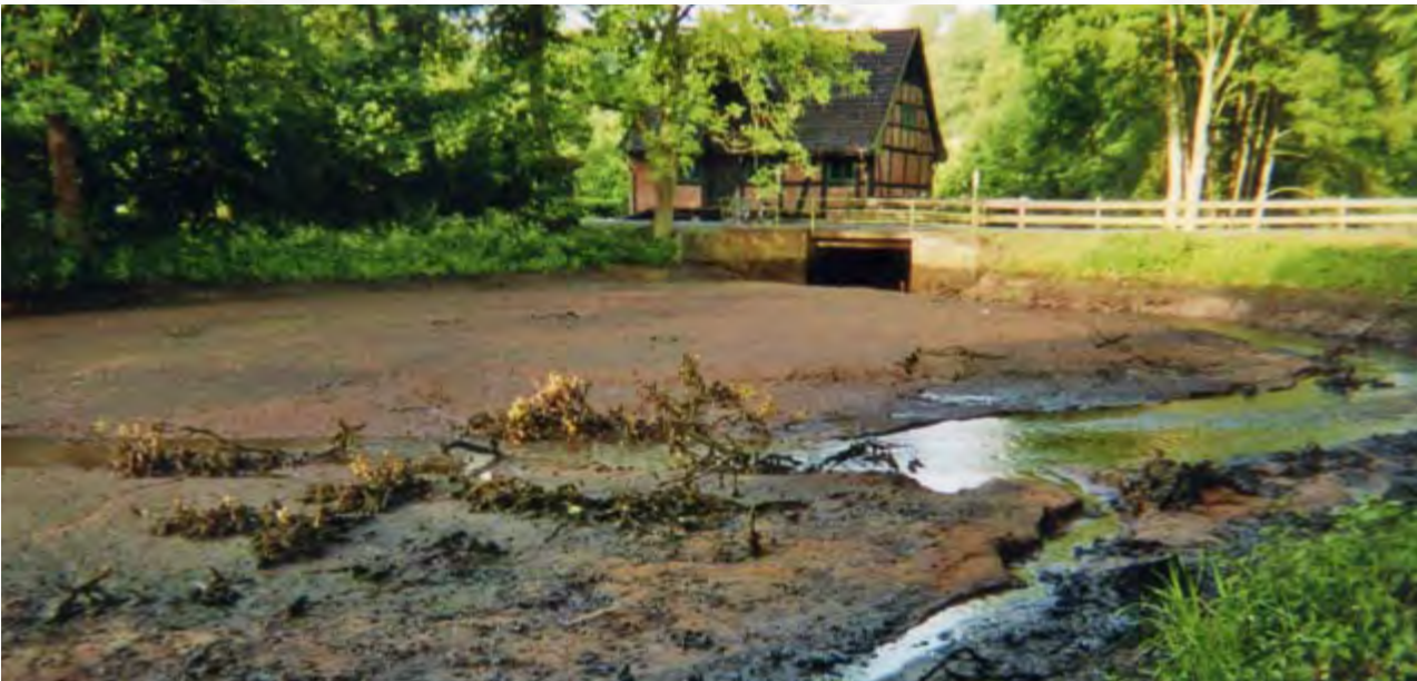
Vorher: Der vor dem Mühlenwehr aufgestaute Teich mit Verlandungserscheinungen (Das Wehr befindet sich unter der Brücke).
