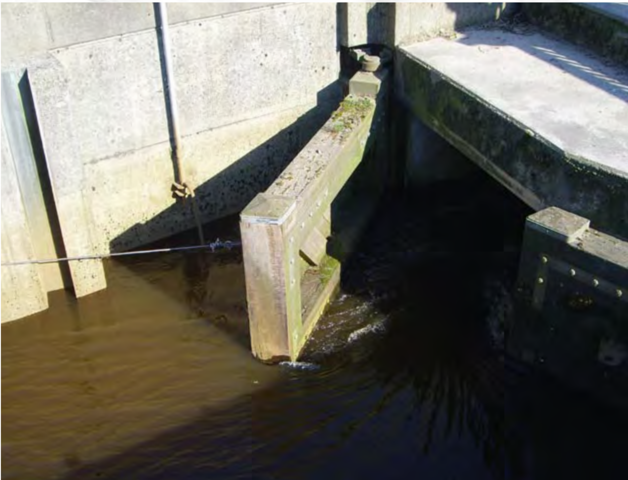
Damit Fische nicht vor verschlossenen Toren stehen, soll der neue Federmechanismus eine Seite des Doppeltors bei auflaufendem Wasser offen halten (hier beim Probelauf noch manuell gehalten)
