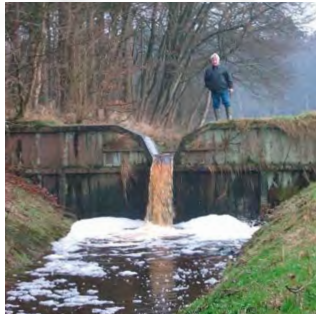
Einer der Sohlabstürze, die in eine Sohlgleite umgewandelt wurden. Kurz vor der Einmündung der Hülsbäke in das Geestrandtief war eine weitere Sohlgleite notwendig, da das Geestrandtief als künstliches Gewässer zu tief in das Gelände eingeschnitten ist, so dass die verbleibende Lauflänge der Hülsbäke nicht mehr ausreichte, um das Gefälle über einen verlängerten Gewässerverlauf auszugleichen.
