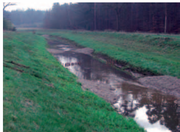
Die Eileringsbecke nach Fertigstellung der Maßnahme. Die Revitalisierung beschränkte sich auf den Gewässerlauf, da seitl. Flächen nicht zur Verfügung standen (1,2 km).
