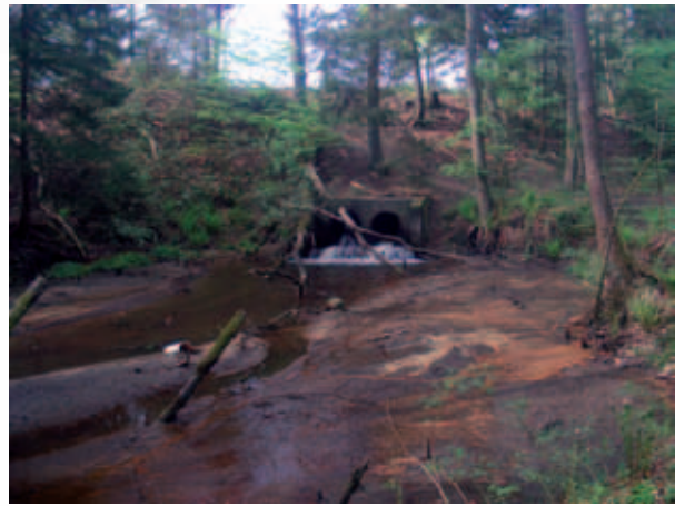
Ausgangszustand - Verrohrungsende mit Kolk unterhalb des Bahndamms
