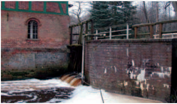
Vor der Maßnahme (Sohlabsturz)
