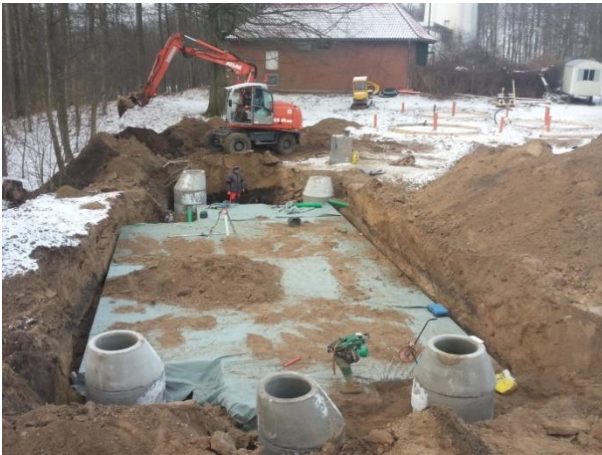
Abbildung 3: Löschwasserzisterne (©OtterWasser GmbH)
