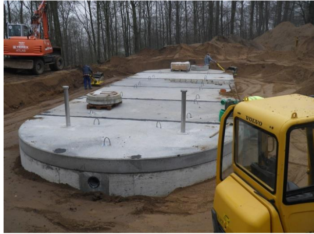
Abbildung 2: Versickerung (©OtterWasser GmbH)
