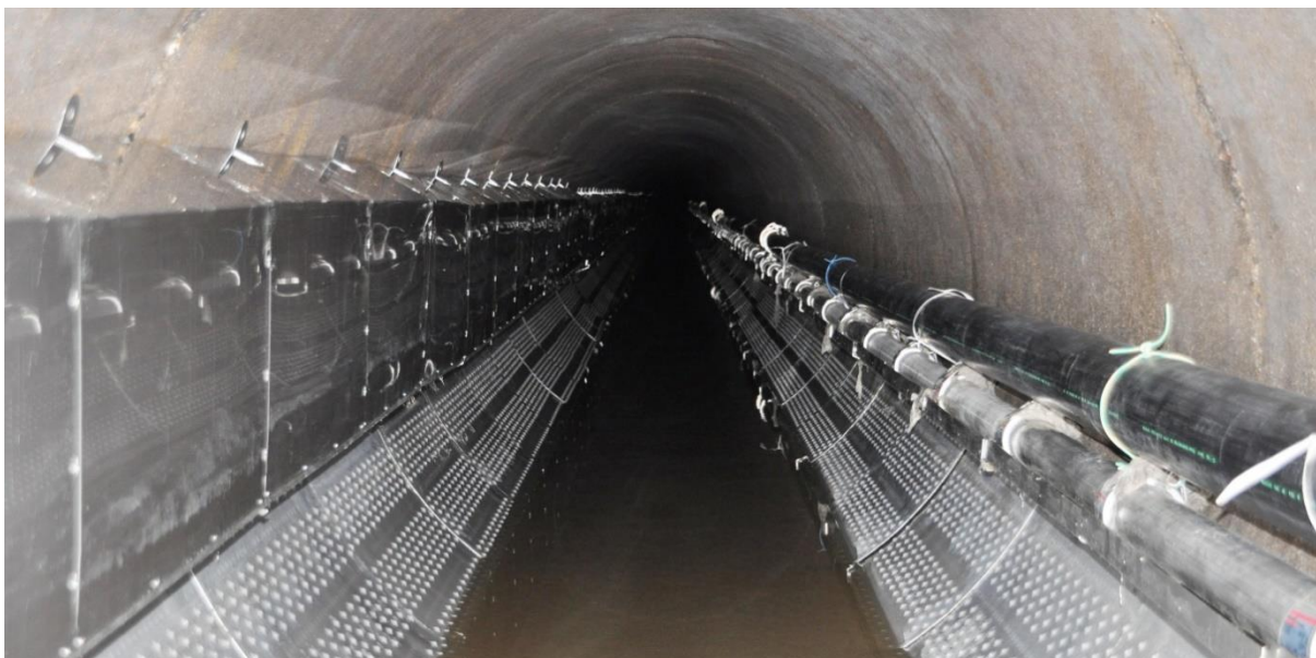
Abbildung 1: Wärmetauscher im Kanal (©OOWV)
